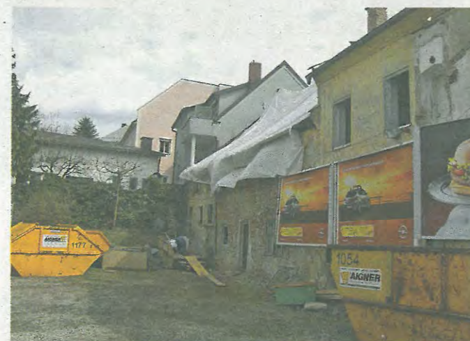
So desolat war das Hafnerhaus vor seiner Sanierung.
